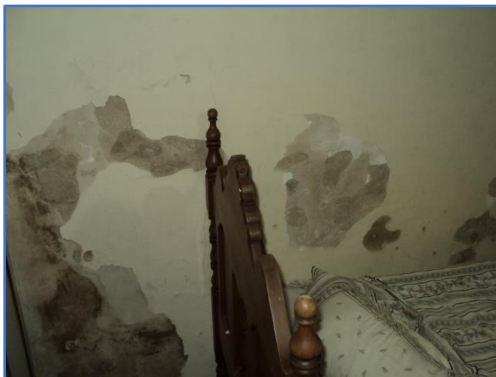
Foto: parede do quarto com infiltração advinda da fachada lateral.
