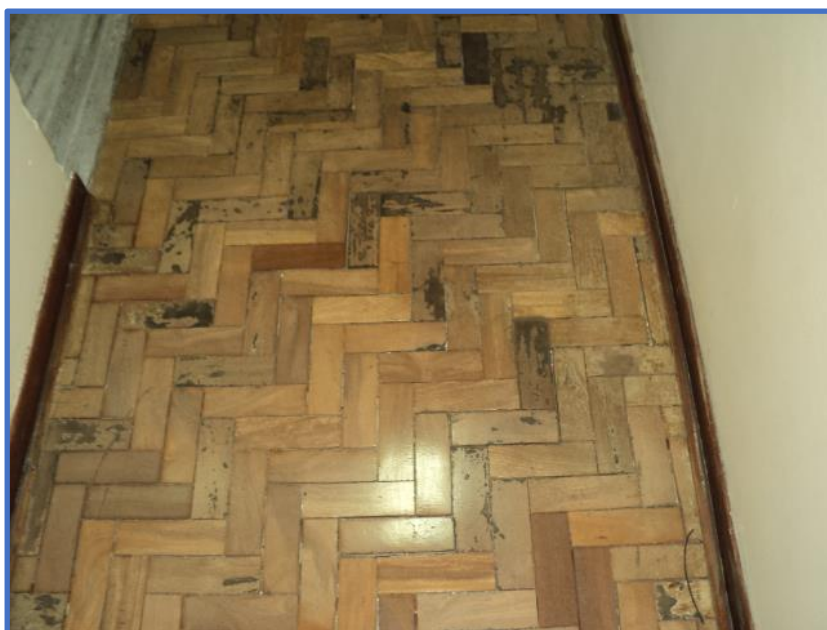
Foto: piso do corredor de acesso aos ambientes em estado de necessitar de manutenção.
